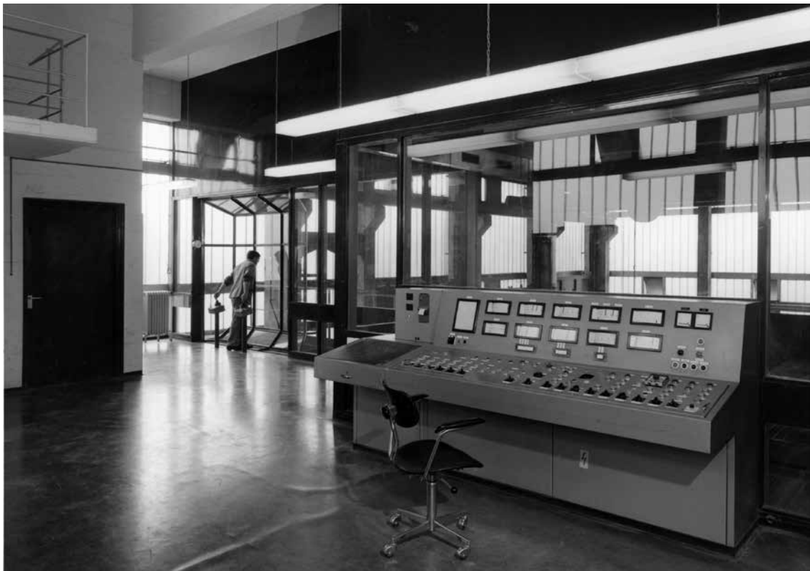
Poste de commande de l'incinération des boues (AVL/Photo M. Vulliemin).
