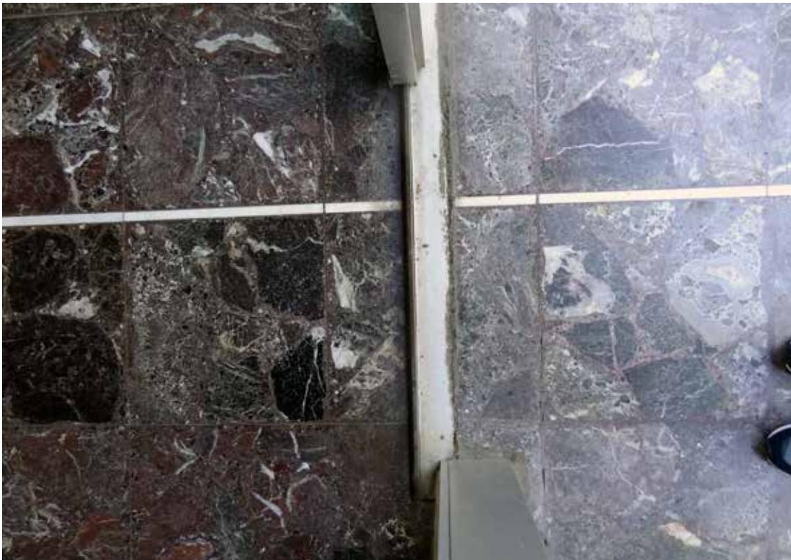
Prolongement du sol en marbre du hall dans le patio (photo Y. Delemontey, 2019).
